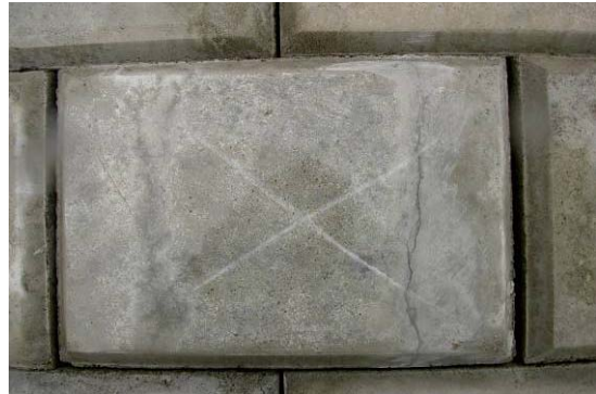
写真-2 クラックの発生状況
