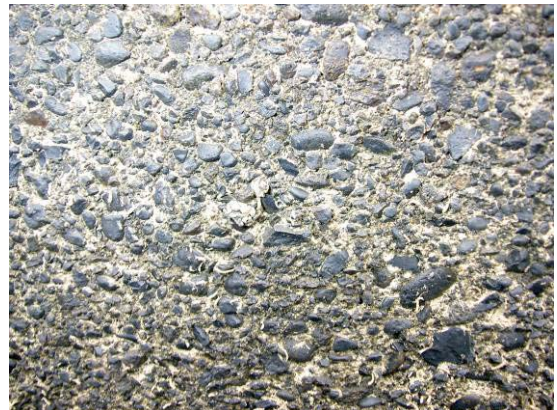
写真-1 水路構造物の表面劣化
