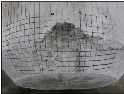
写真3 コンクリート未充填箇所
