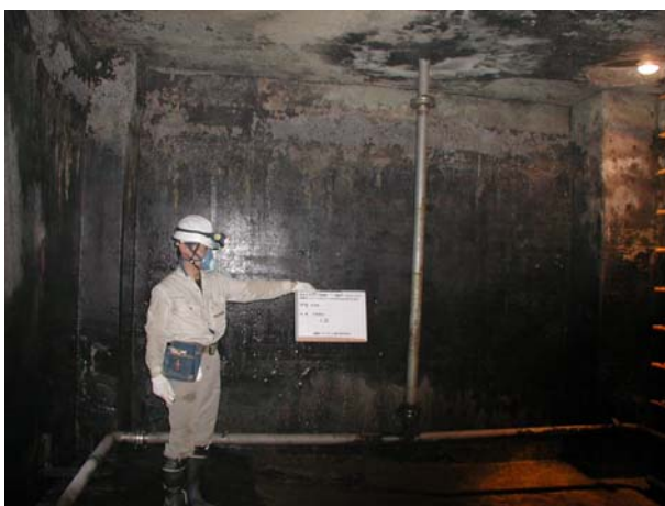
写真 - 1 液相部劣化状況
