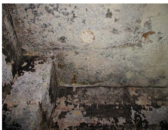
写真 - 2 気相部劣化状況
