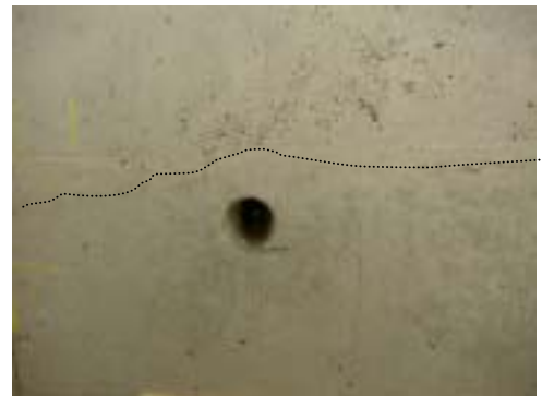
写真2 コールドジョイント状況
