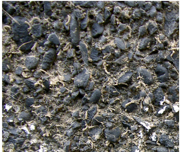
写真1 水路コンクリートの表面劣化
