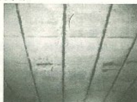
写真3 構造物劣化状況
